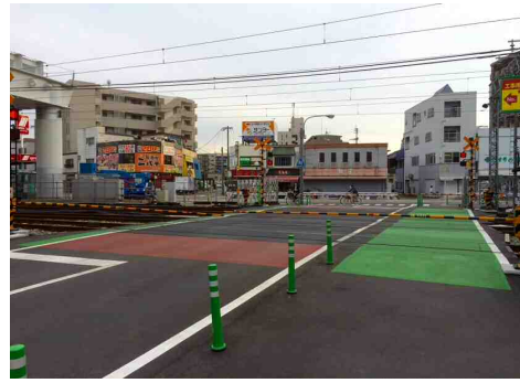
(春日原駅南) 仮駅ホームの拡張に伴い、春日原1号踏切を高架化後に新設される 都市計画道路・春日原駅前線の位置へ平成27年7月に移設しました。
