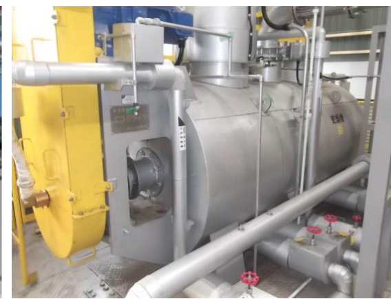
播磨工場 真空汚泥乾燥機
