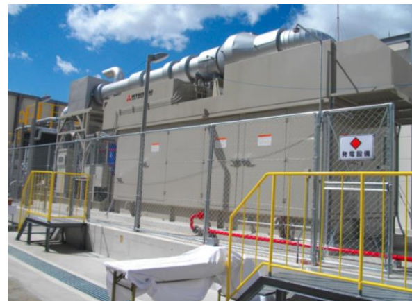
淀川工場 815kWガスエンジン
