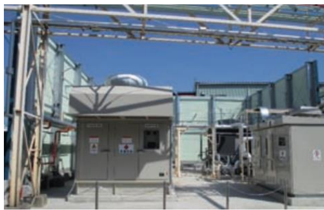
播磨工場 815kWガスエンジン
