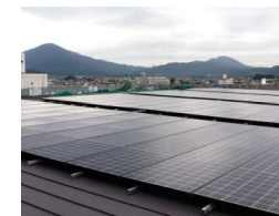
太陽光発電設備
