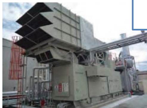
ガスタービンコージェネレーション 外観
