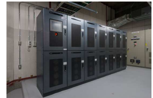
【共用部 蓄電システム】 (マンション全体のDRに利用)
