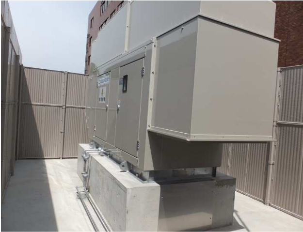
非常用発電機(屋外) 150kva
