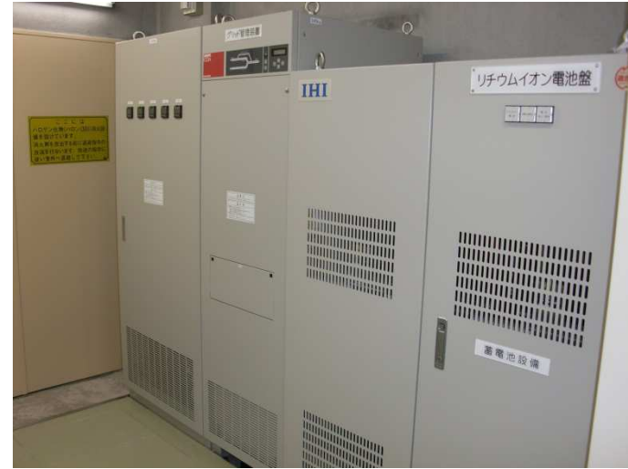
蓄電池盤(25kwh) グリッド管理装置
