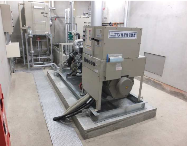
非常用発電機(屋内) 100kva
