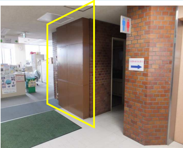
新設分電盤(災害時電源供給)
