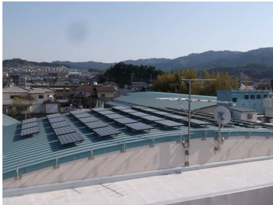
太陽光パネル10kw
