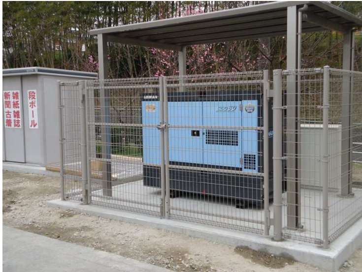
災害用発電機 (可搬型)60kva 屋外設置
