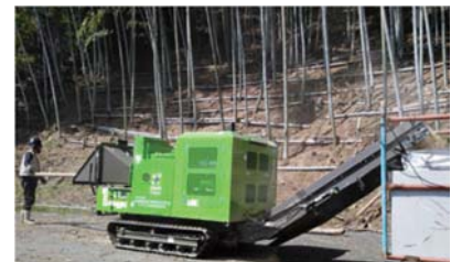
導入された竹専用の大型チッパー
