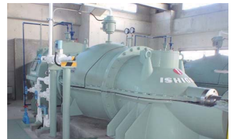
柳川地区で整備した排水ポンプ
