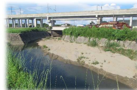
<土砂が堆積した河川>
