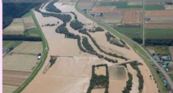
越水による堤防の法崩れ(常呂川)
